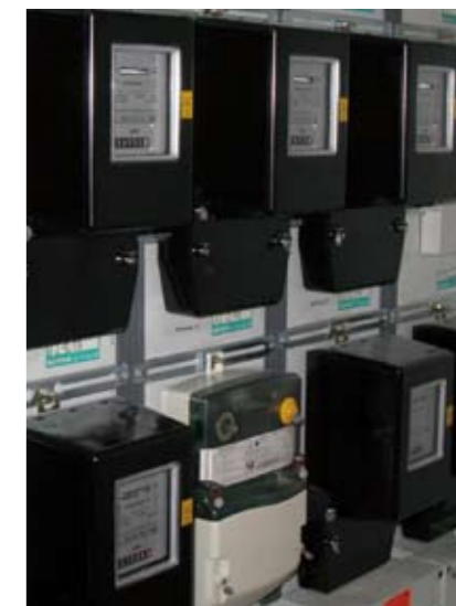
Abb.2: Heute noch in der Unterzahl: Das Verhältnis zwischen eingebauten Ferraris-Zählern und Smart Meter wird sich in den nächsten Jahren umkehren.
